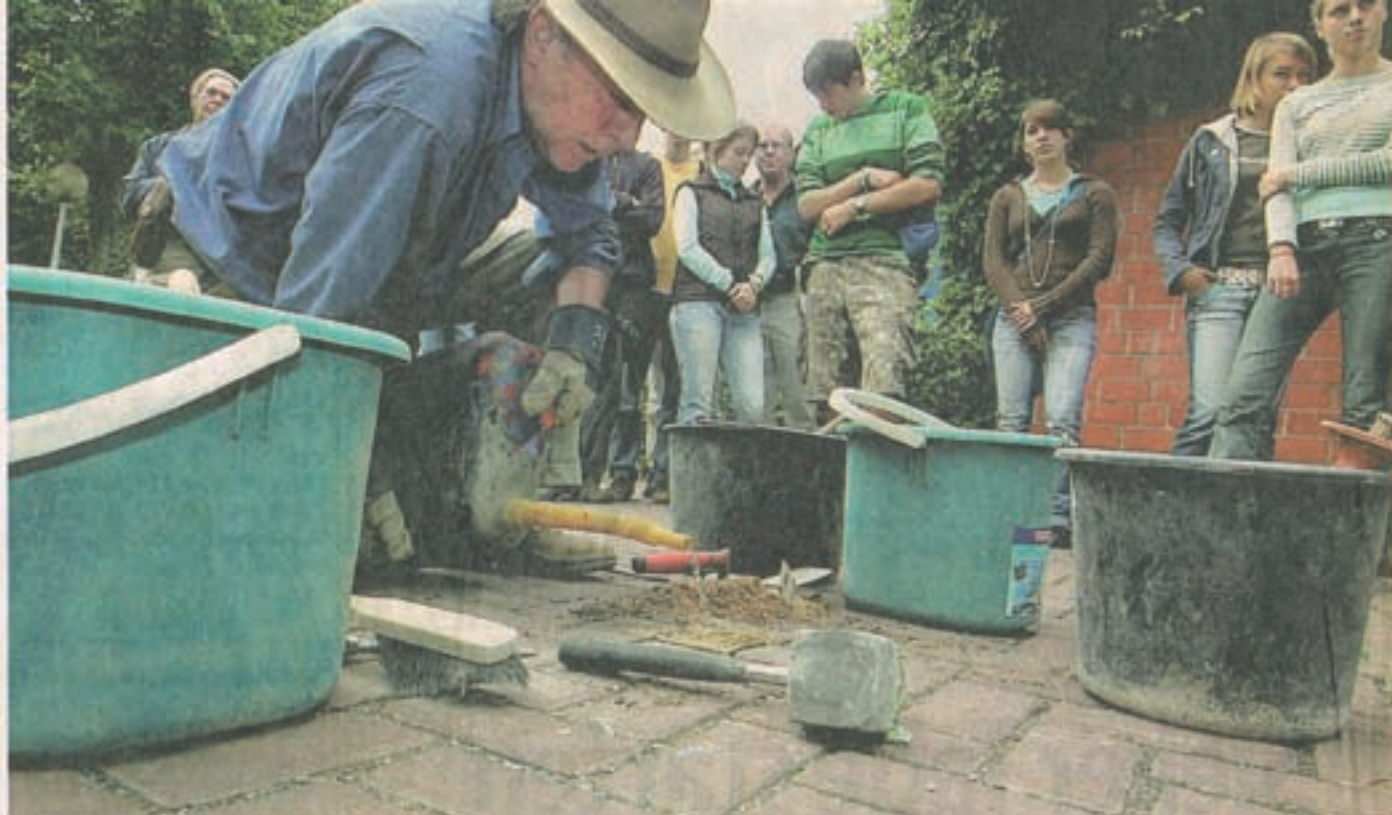
Beim Pflastern: Gunter Demnig vor dem Schuleingang am Wortkamp 3. Im früheren Haus 35a lebte Schweitzer, bis ihn die Nazis holten.
